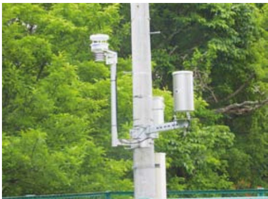
気象観測機器(電柱設置型)
