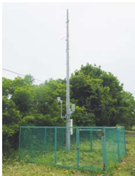
町内7箇所に設置されている気象観測機器の全景
